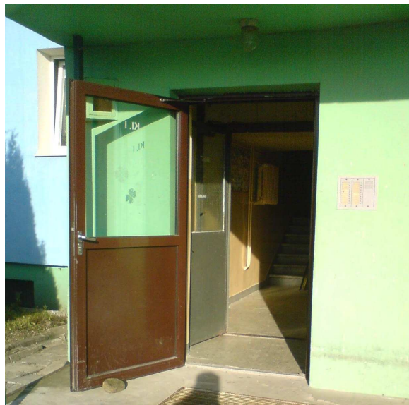
„Wietrzenie” klatki nr I w budynku przy ul. Mickiewicza 12, w dniu 2009-11-20
